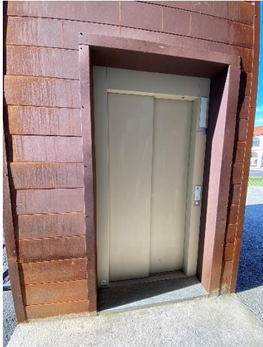
Ascensore biblioteca soglia
