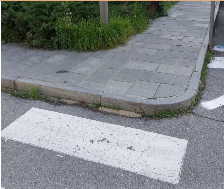
Dislivello causato da gradino di 2,5/20 cm
